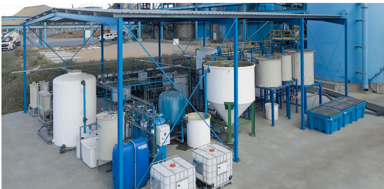
Figura 3. Vista general de los trenes de tratamientos innovadores desarrollados en REMINE WATER.
