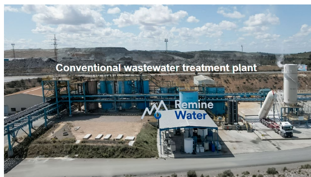
Figura 2. Vista general de la planta de tratamiento de aguas residuales convencional de Matsa y del piloto REMINE WATER.
